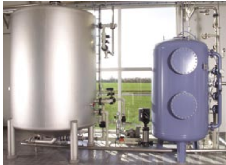
Die Entfernung von gelösten Gasen wie aggressive Kohlensäure, Methan und Schwefelwasserstoff ist die Voraussetzung für eine optimale Filtration. Photo: Entgasung und Druckfiltration in einer Brauerei.
