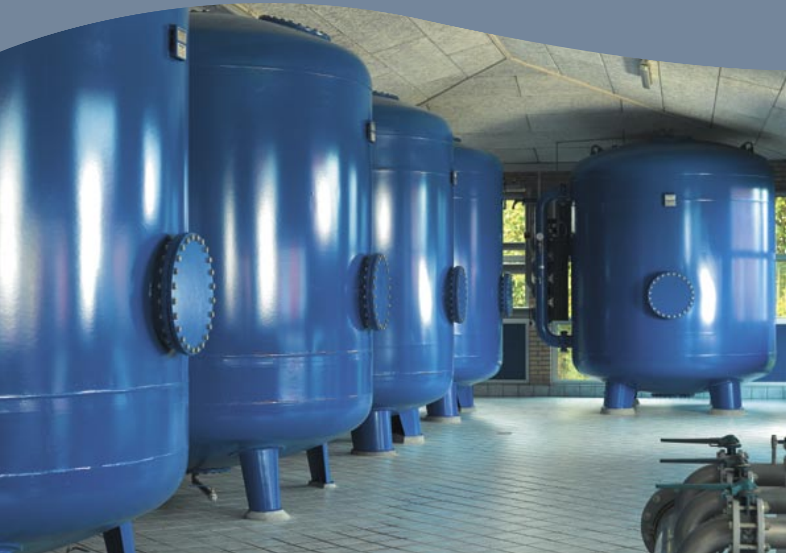
Reduzierung von Eisen, Mangan, aggressiver Kohlensäure und Ammonium in einem Wasserwerk. Die Anlage besteht aus 5 parallel geschalteten Druckfiltern Typ TFB 75, Gebläse und Spülpumpe. Durchsatzleistung: 265 m 3 /h.
