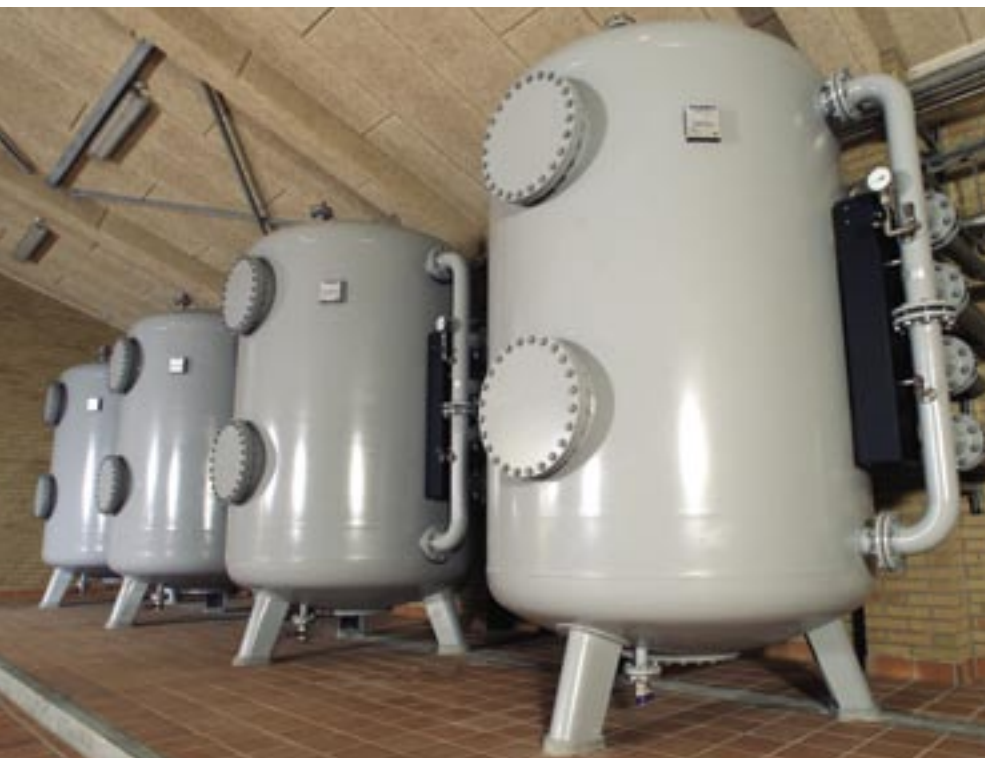
Reduzierung von Eisen, Mangan und Ammonium in einem Wasserwerk. Durchsatzleistung: 2 x 35 m 3 /h.
