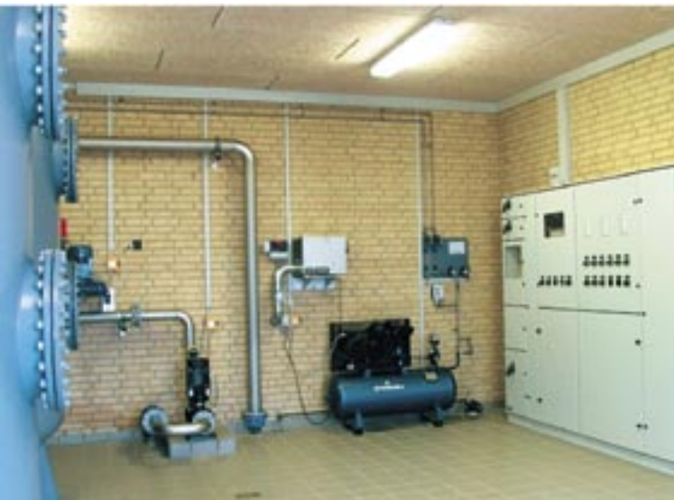
Eine komplette Wasseraufbereitungsanlage umfasst außer einem Druckfilter auch Anlagenteile für Oxidation und Rückspülung.
