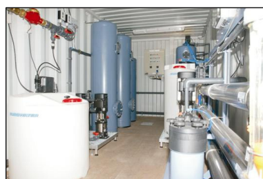
Beispiel einer kundenspezifischen Lösung mit Dosierung, Enthärtung, Kohlefiltrierung und Umkehrosmose
